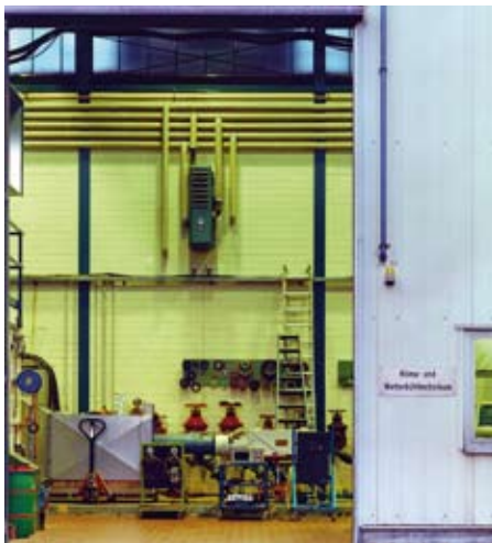
Der „KWT“ Prüfstand für Kälte-, Klima- und Wärmetechnik
