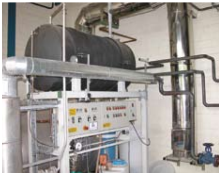
Die exakte Luftbefeuchtung der Zuluft erfolgt über einen Schnelldampferzeuger
