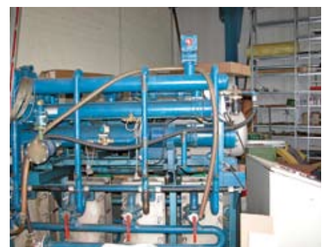
Externe Kälteanlage für die Leistungsprüfung von kältetechnischen Komponenten
