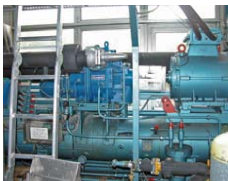
Das benötigte Kaltwasser wird mit einer Ammoniak-Kälteanlage erzeugt
