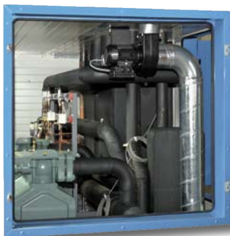
Blick durch die seitliche Revisionstür, gut sichtbar der Fortluftventilator mit dem zum Boden reichenden Ansaugrohr
