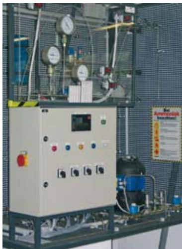
NH 3 -Anlage im Handwerkskammer Bildungszentrum Münster
