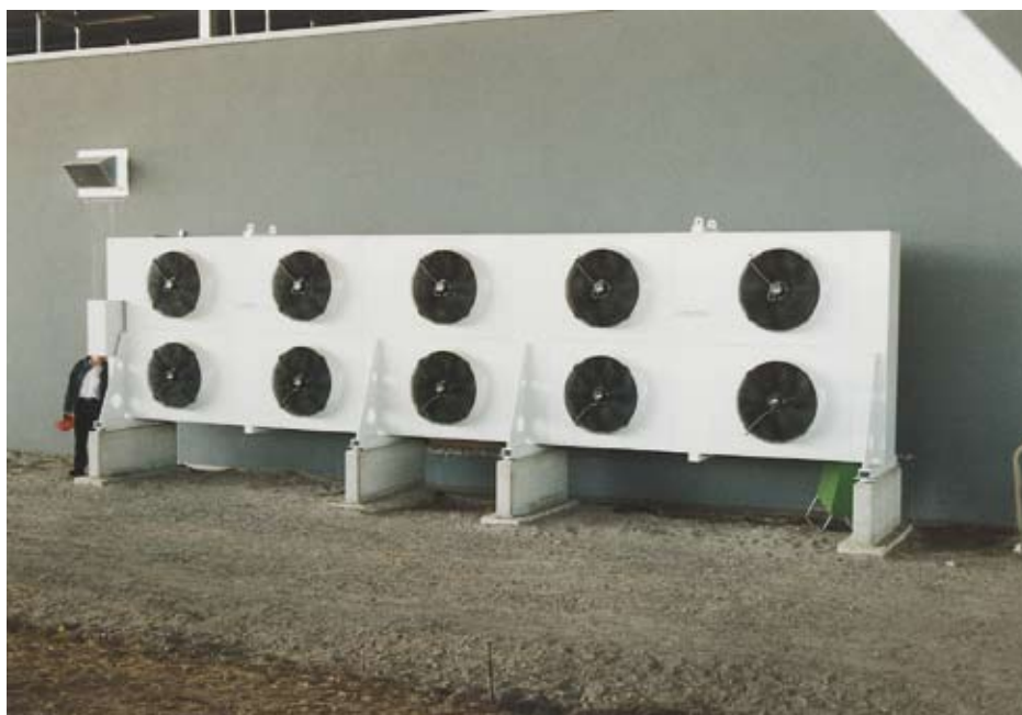
Rückkühler (Fabrikat thermofin) für die Ölkühlung der Schraubenverdichter, Gesamtleistung 415 kW bei einer Austauschfläche von 2183 m 2 /h
