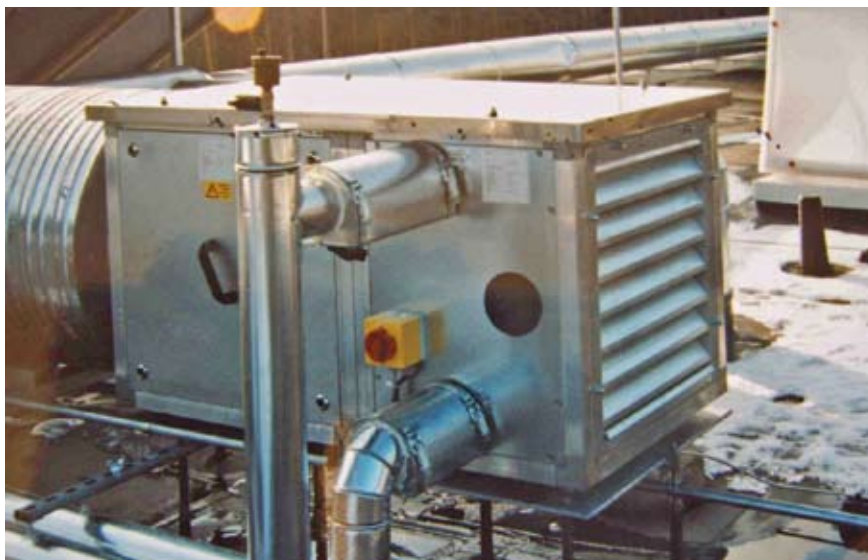
Zentrale Abluftgeräte mit Wärmepumpe werden künftig in der DIN 1946 Teil 10 beschrieben und die Planung im Teil 6 behandelt
