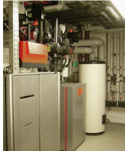
Zwei Wärmepumpen beheizen die Kirche und Gemeindezentrum mit kostengünstiger und umweltfreundlicher Erdwärme aus dem Grundwasser
