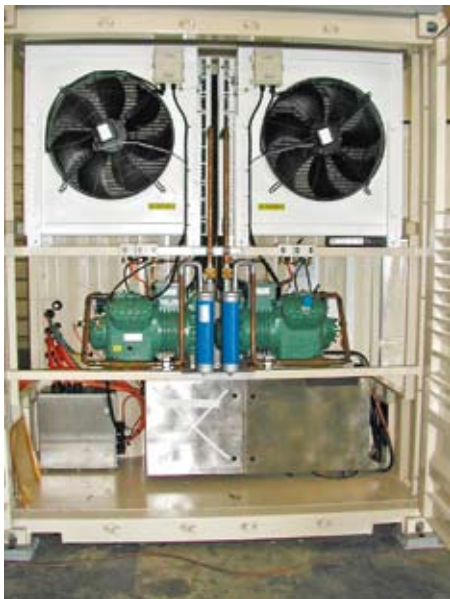
Innenansicht des Containers mit der redundanten Anlage
